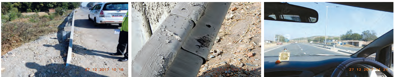
चित्र 8: अनुचित तरीके से MCB को मिलनाय RSA के प्री-ओपनिंग स्टेज उद्घाटन से पहले, अनधिकृत खुला मिडियन, क्षतिग्रस्त MCB प्रतिस्थापन
